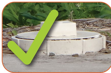
Tanque séptico sellado con tapa de PVC.
