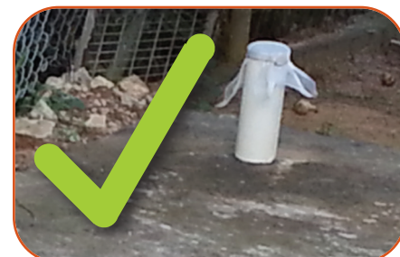
Tubo de ventilación de un tanque séptico con malla o tela metálica.
