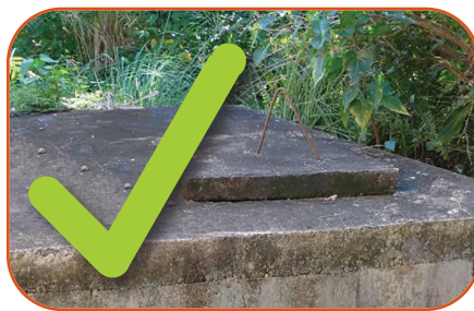
Tanque séptico con cobertor de concreto.
