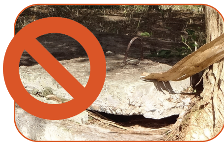
Repare los cobertores rotos de los tanques sépticos.
